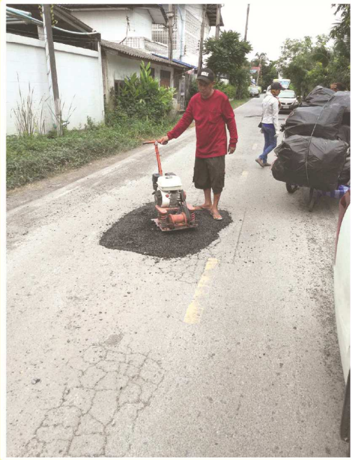
ซ่อมแซมถนนเลียบบคลองระบายน้ำที่ 2 (ฝั่งตะวันตก) หมู่ที่ 3 ตำบลคลองสอง
