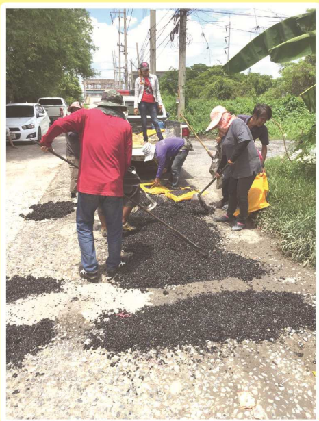
ซ่อมแซมถนนเลียบบคลอง บริเวณซอยบงกช 26 (เคหะแก้วนิมิตร) หมู่ที่ 3 ตำบลคลองสอง
