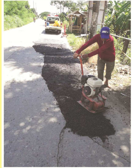
ซ่อมแซมถนนเลียบบคลองระบายน้ำที่ 9 (ฝั่งตะวันตก) หมู่ที่ 6 ตำบลคลองสอง
